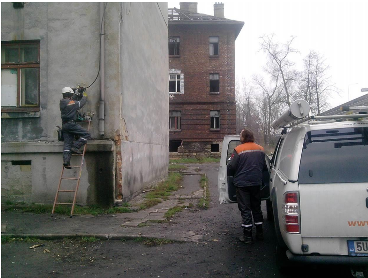
Pracovníci ČEZ přerušují dodávku elektřiny
