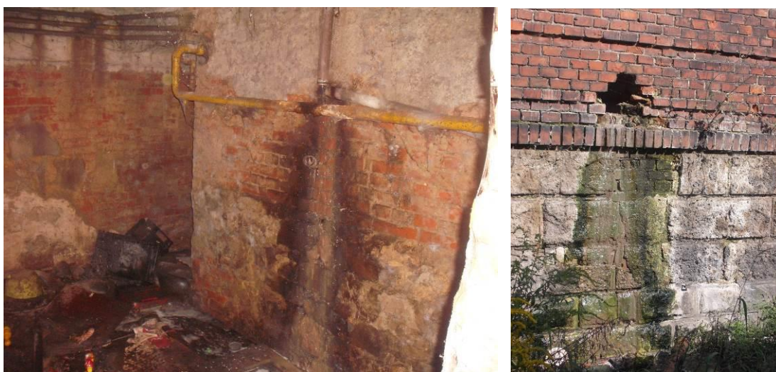
Sklepní prostor - vytékání splašků z trubek. Vytékání splašků ze zdi do venkovního prostoru
